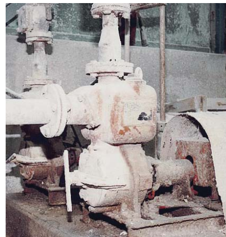
Насосы 10 Series® перекачивающие сточные воды с твердыми примесями на сталеплавильном заводе в штате Огайо, США.
